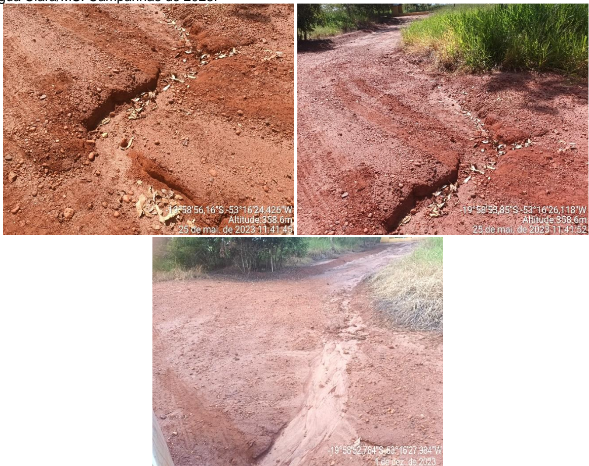
Figura 4. Ponto 2: Erosão em sulcos no acesso interno da área 1 da PCH Verde 4, no município de Água Clara/MS. Campanhas de 2023.
