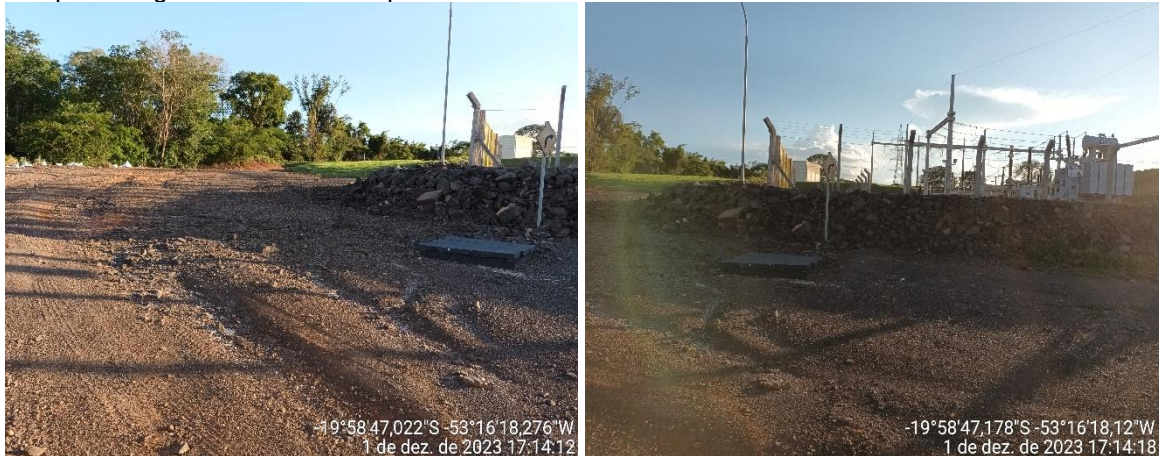
Figura 5. Ponto 3: Erosão em sulcos na da via de acesso a casa de força, área 1 da PCH Verde 4, no município de Água Clara/MS. Campanha de 2023.
