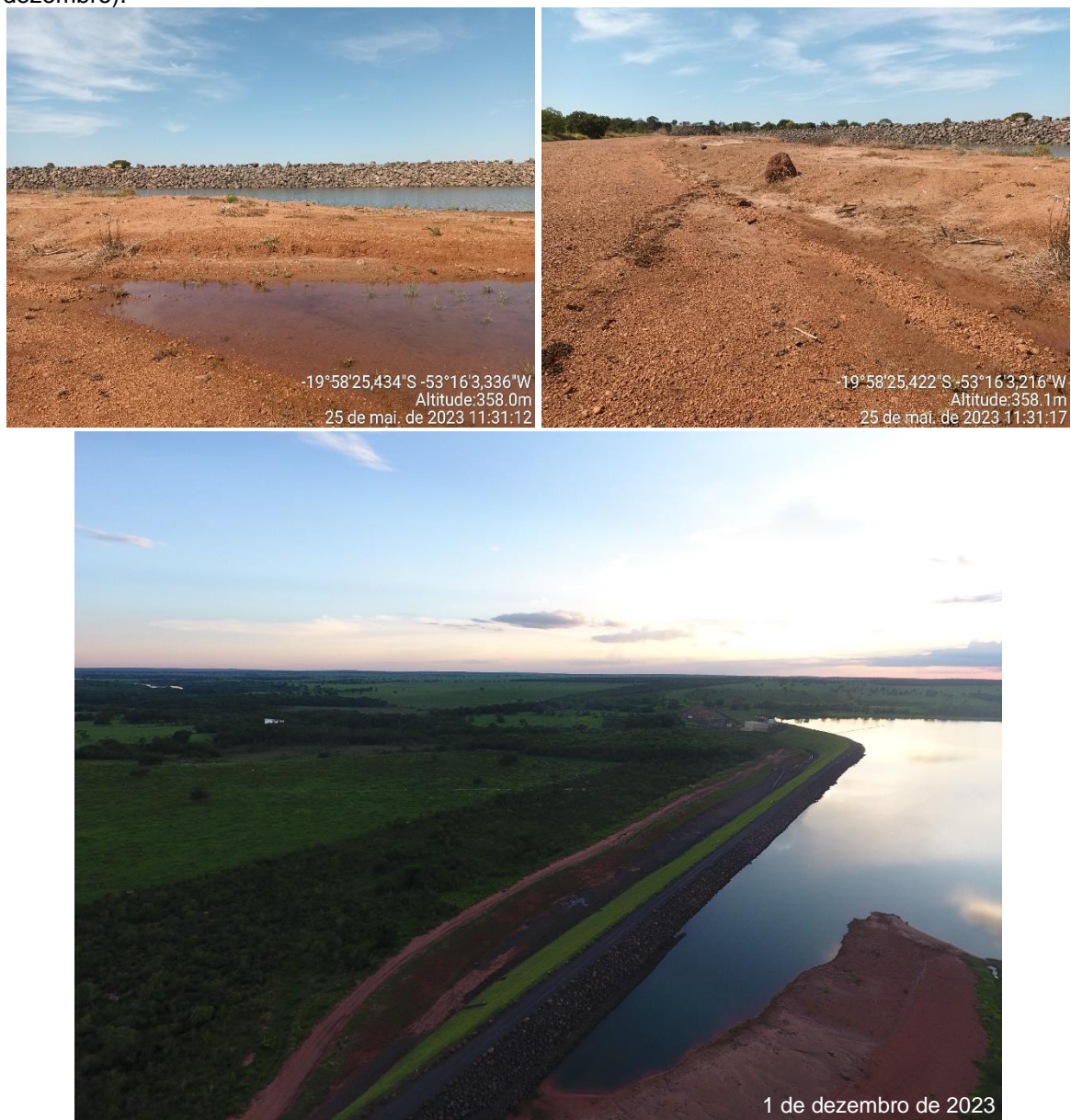
Figura 3. Ponto 1: Marcas de erosão em sulcos na margem, ausência de cascalho ou vegetação, área 1 da PCH Verde 4, no município de Água Clara/MS. Campanhas de 2023 (Fotos 1 e 2 - maio e foto 3 – dezembro).
